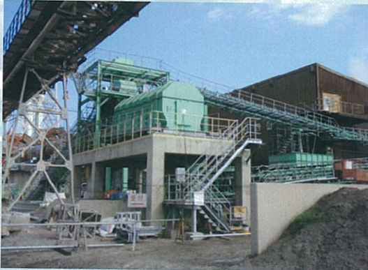
■ 製鐵所副産物選別用 (設置現場)
