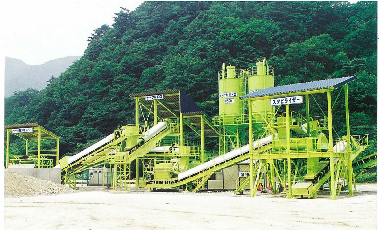
脱水ケーキリサイクルプラント
