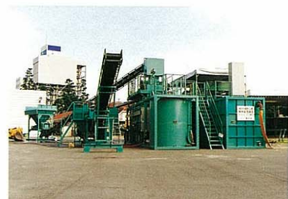
土砂・汚泥処理システム
