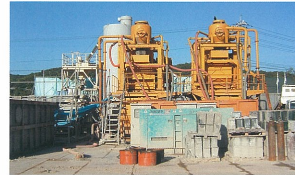
浚渫汚泥のリサイクルプラント
