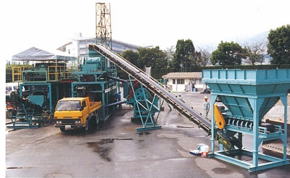
汚染土壌浄化プラント
